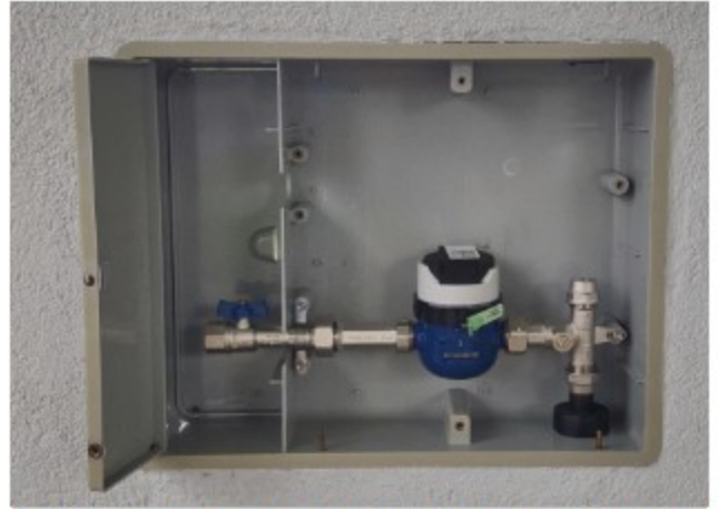
Imagem 2: frente sem a tampa e porta do registro aberta
