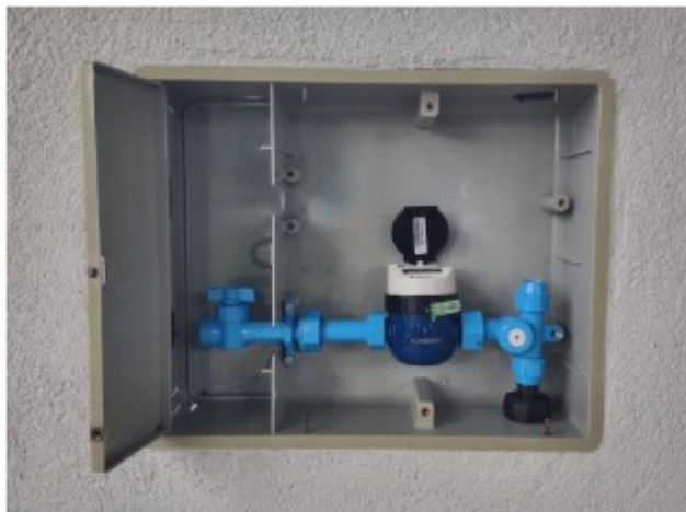
Imagem 2: frente sem a tampa e porta do registro aberta
